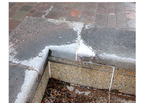
Irreparable technische Schäden und Flickstellen an den Betonelementen, Stand 2005
